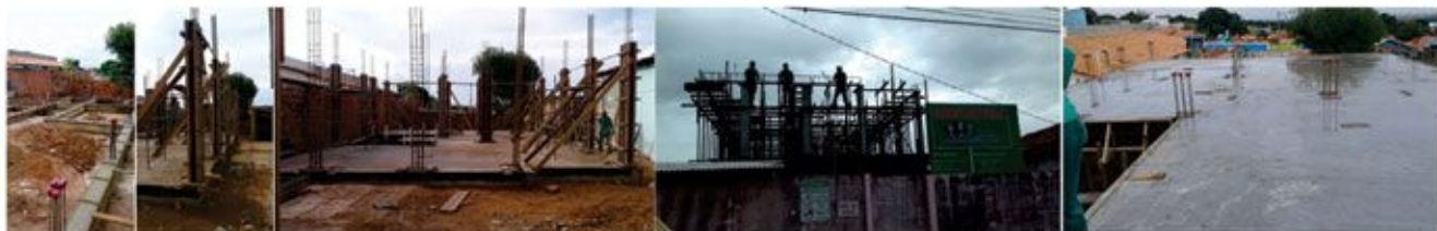
Reconstrução de imóvel em Açailândia transforma-se em patrimônio para a luta dos ferroviários, em sub-sede estruturada e confortável
